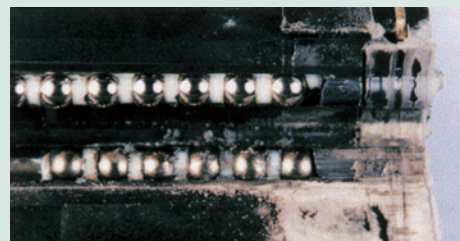
볼 전동면에 다량의 이물 유입
